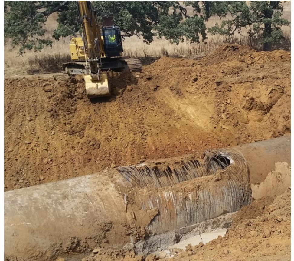
2015 Santa Clara Conduit Rupture – PCCP
